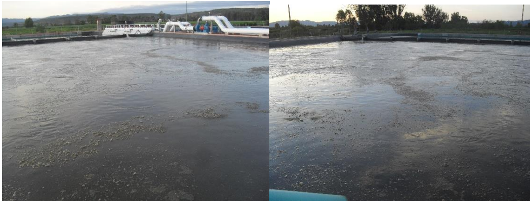
Figura 9 Lodos activados en la PTAR Sur
