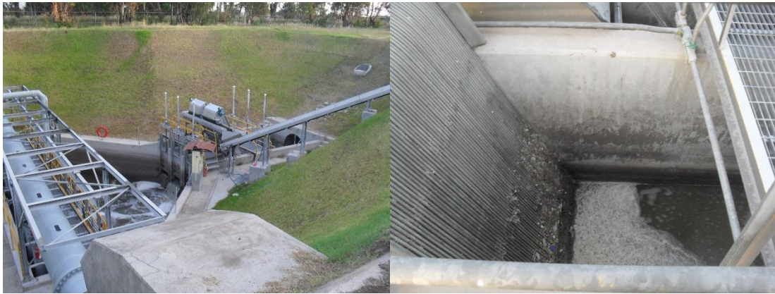
Figura 8 Recepción y cribado del agua residual en la PTAR Sur
