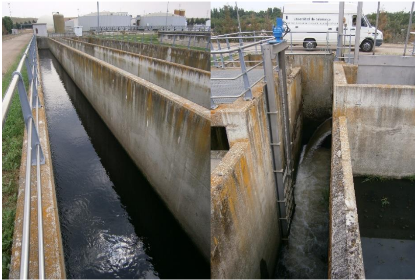
Figura 15 Último paso en el tratamiento del agua
