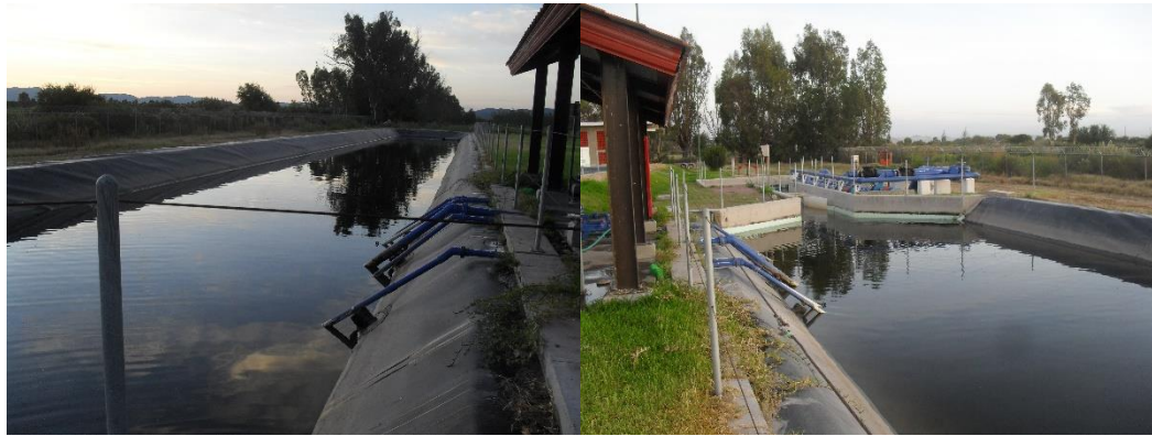
Figura 10 Canal de cloración en la PTAR Sur
